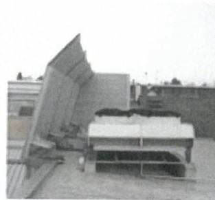
Lärmschutzwand vor Kühlaggregat
